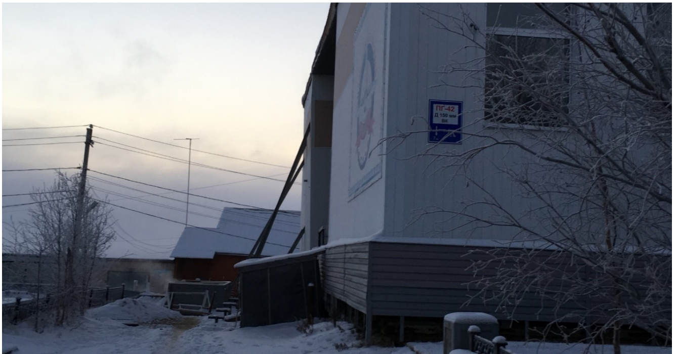
Рисунок 66 — Неравномерная осадка здания Ямальского полярного агроэкономического техникума (фото автора)
