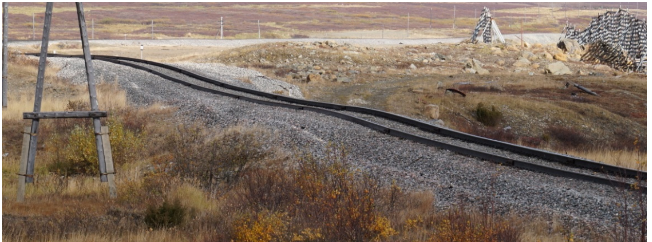
Рисунок 75 — Деформации железнодорожного полотна (фото автора)
