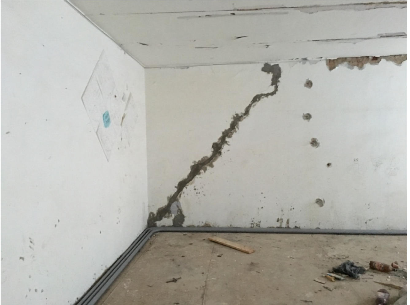
Рисунок 67 — Трещина во внешней стене здания Ямальского полярного агроэкономического техникума (фото автора)
