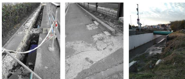
Рисунок 2.11 – Фото дренажной канавы (а) и участков ремонта дорожного полотна (б) с выступающими над поверхностью земли канализационными люками на ул. Кувшинок (п. Мирный). (в) фото дренажного канала вблизи ул. Журналистов.
